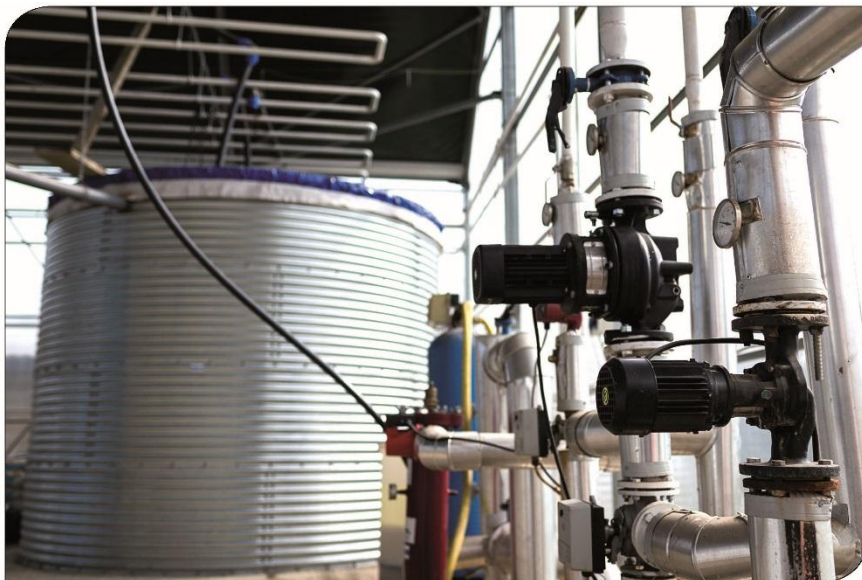
Instalații moderne în serele spitalului
