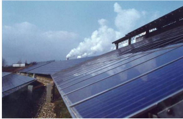
Figura 3.22: Centrală energie fotovoltaică de la RWE Neurath Lake, Germania
