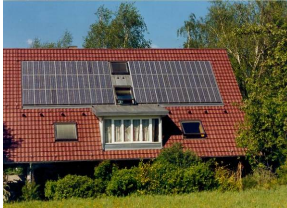
Figura 3.20: Generatoare fotovoltaice conectate la rețea pe acoperișul unei case (Kirchzarten Germania)
